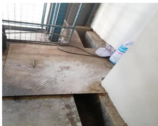
车间事故排水沟
