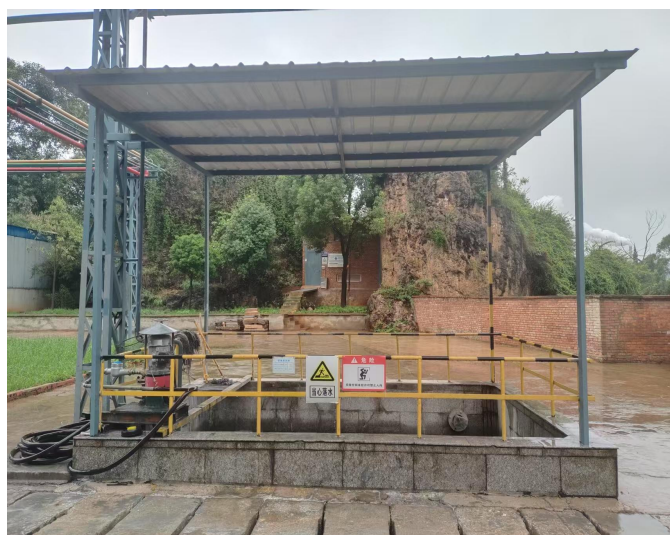
磷酸储区旁污水收集池
