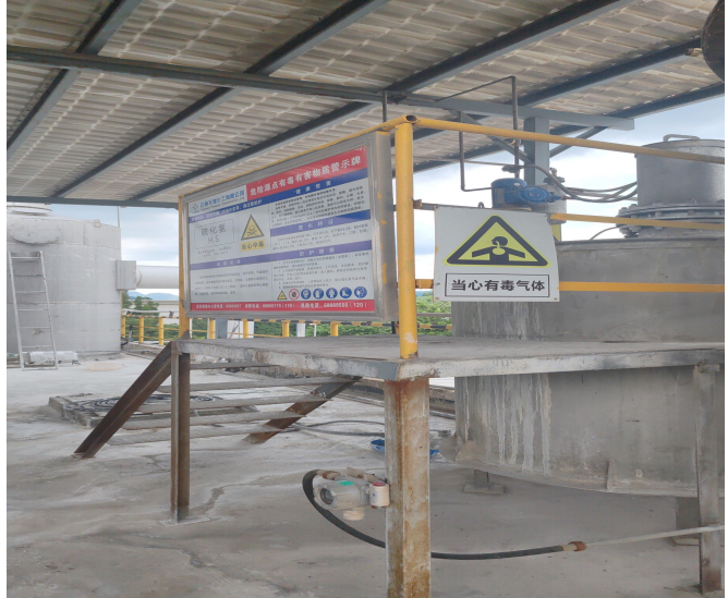
厂区内硫化氢有毒有害物质警示牌
